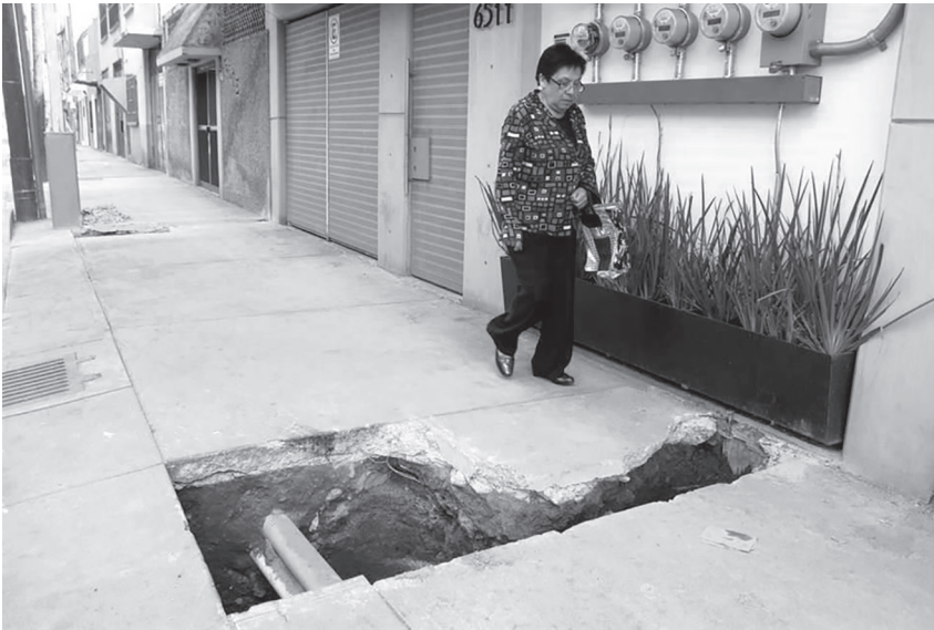
Fotografía 7 Zanja cubriendo casi la totalidad de la banqueta Ciudad de México
