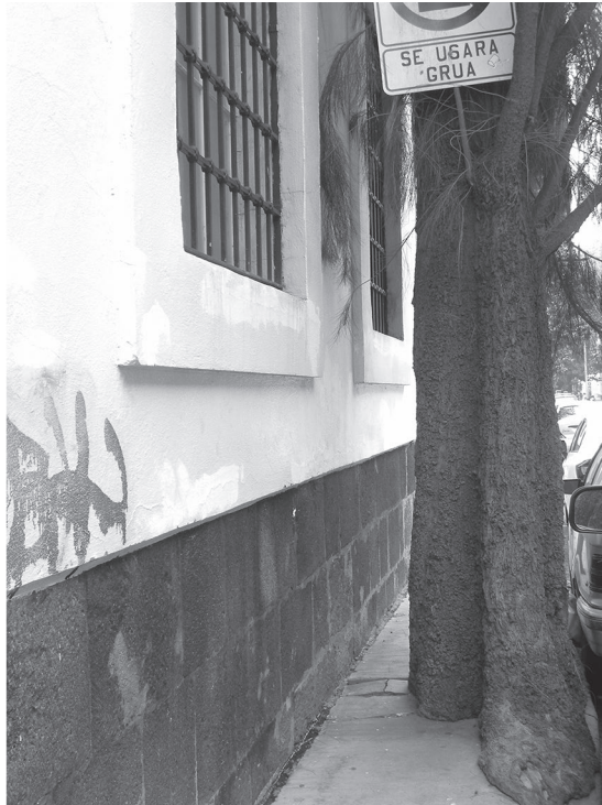
Fotografía 1 Menos de 30 cm de banqueta entre árbol y muro junto a un asilo de ancianos, Centro Histórico
